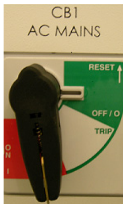
Disjuntor da fonte de CA
